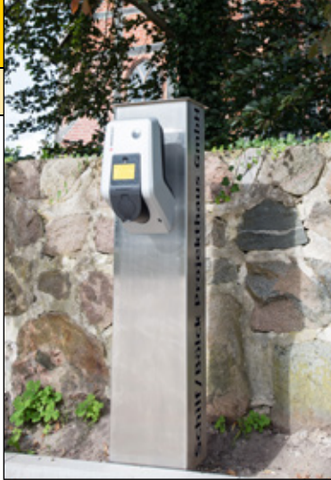
Moderne Tanksäule für Elektroautos
